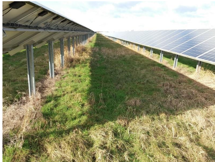
Abbildung 6: Aufnahme einer Freiflächenanlage auf einer Grasfläche - Quelle: Eigene Aufnahme
